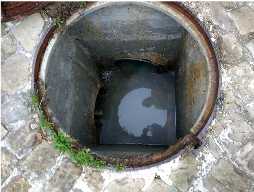
Foto pozzetto fognario con chiusino in ghisa sferoidale circolare
