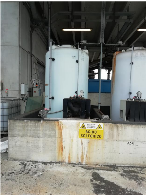
Serbatoio acido solforico al 30% scrubber essiccamento termico depuratore di Jesi (AN)
