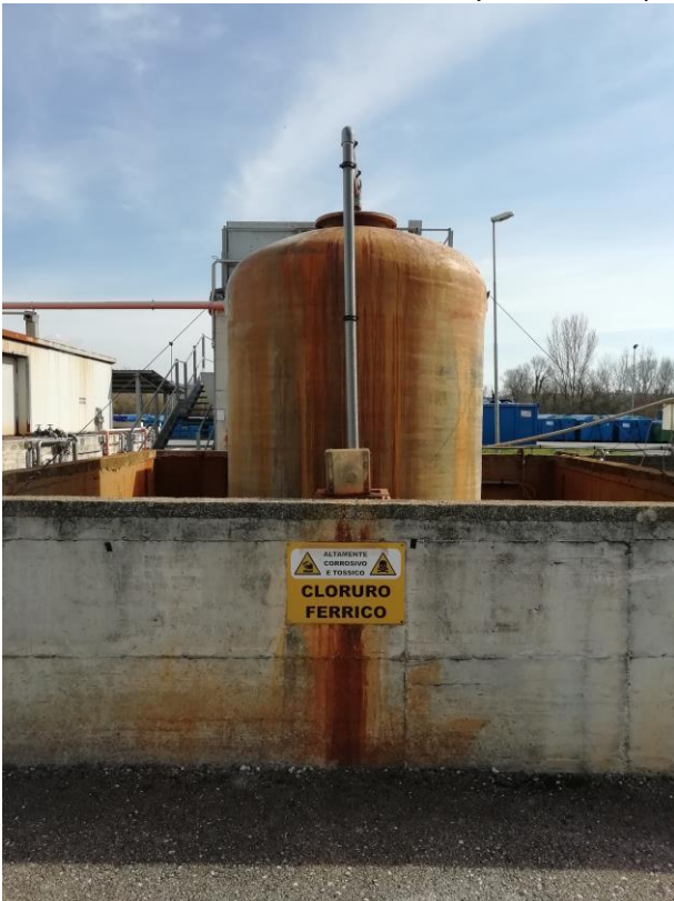
Serbatoio Cloruro Ferrico 40% in peso del Depuratore di Jesi (AN)
