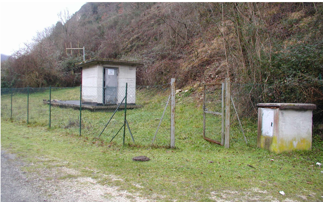
Esempio area esterna complesso acquedotto - Sorgente Le Vene di Esanatoglia - A-615
